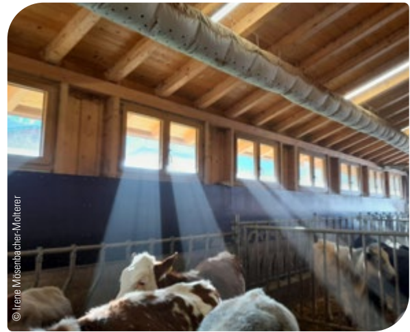
Abb. 11: Schlauchbelüftungen sorgen in Kälberställen für frische Luft
