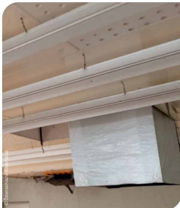
Abb. 23: Die angewärmte Luft gelangt über eine Porendecke in den Stall
