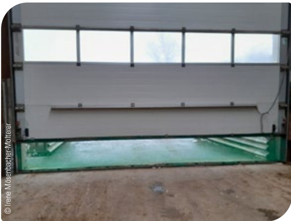
Abb. 13: Während der Wintermonate ist auch eine Frischluftzufuhr über Tore am Futtertisch möglich, wobei Windschutznetze die einströmende Luft abbremsen
